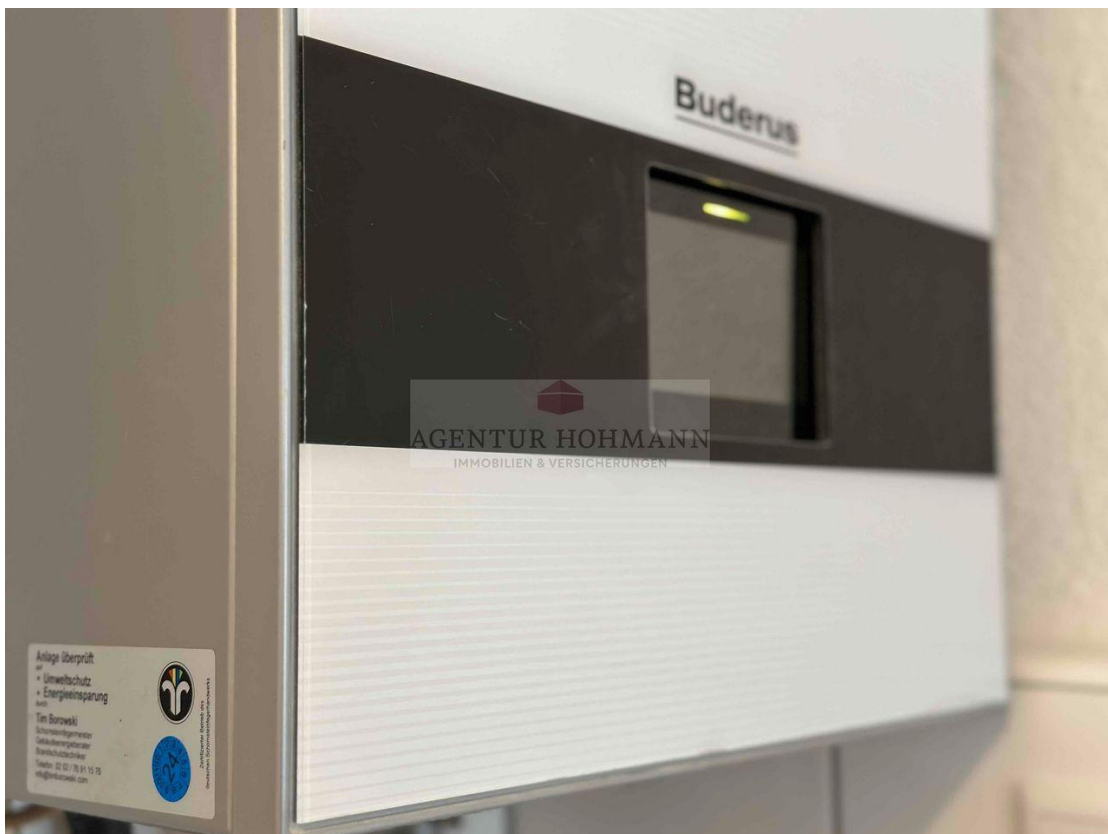
Gasetagenheizung, Kombitherme (Bj. 2024)
